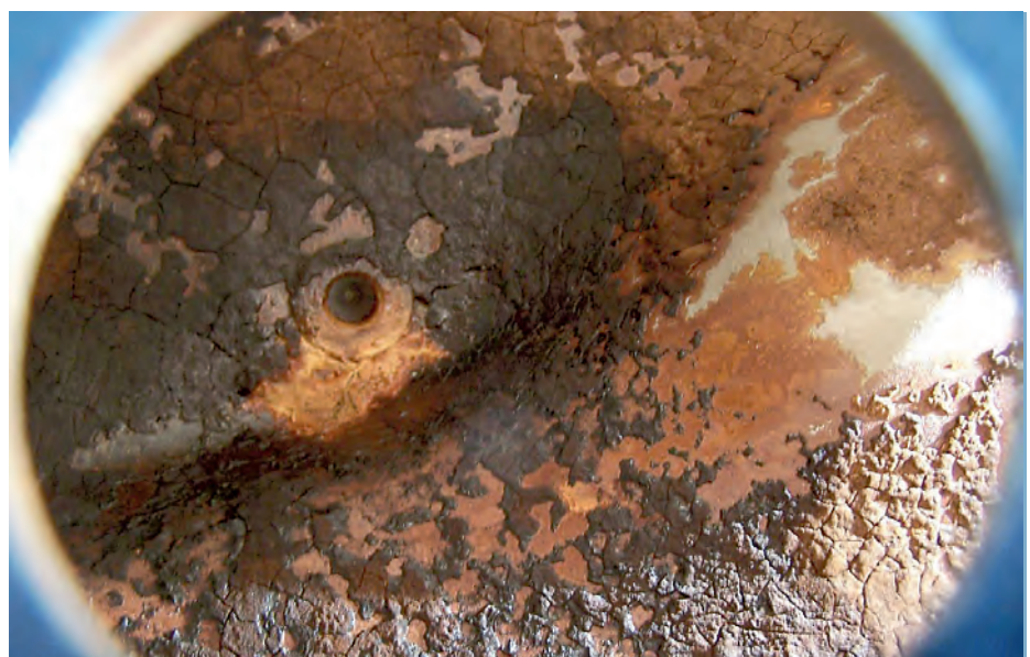
So kann ein mit Dieselpest befallener leerer Tank von innen ausschauen. Die schlammartige Masse unterscheidet sich deutlich vom Rost und dürfte bereits weiter vorgedrungen sein
